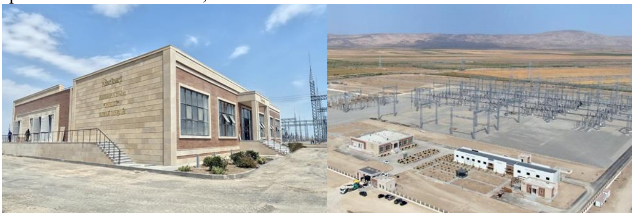
Подстанция 500/330/10 кВ «Навай»
