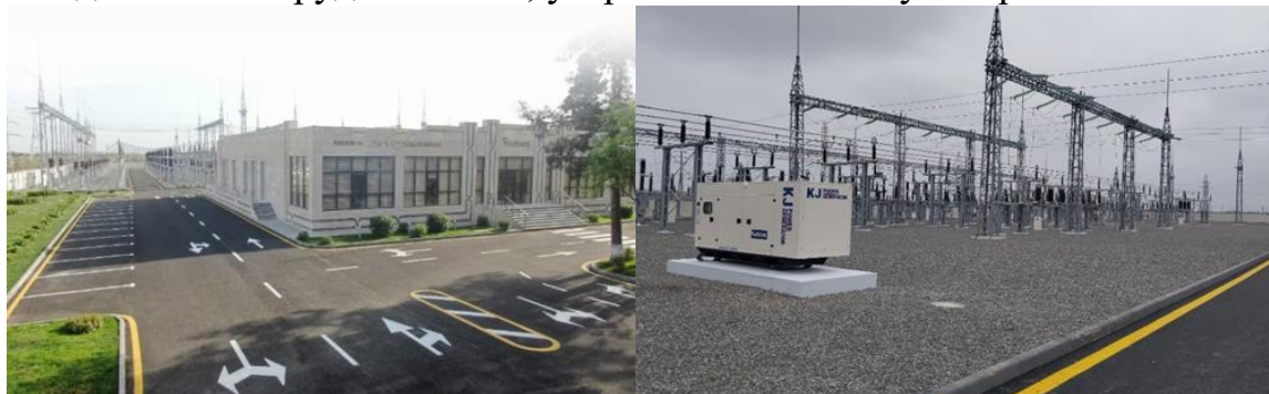
Подстанция 110/35/10 кВ «Евлах»
